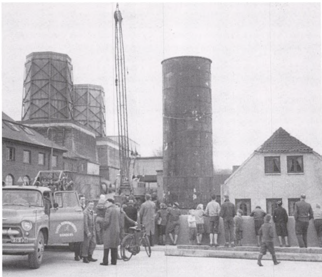
I april 1957 blev den gamle fjernvarmebeholder fjernet. På grunden blev opført en moderne folkerumsbygning.
