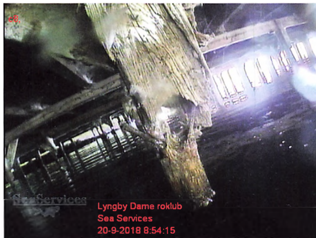
Et af de mange fotos, som Sea Services dykkere tog nede under huset. Foto: Sea Services.
