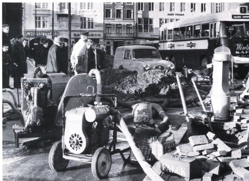
Flakhaven har gennem årene været gravet op adskillige gange. Her skyldes opløbet sikkert brud på en vandledning (Møntergården).
