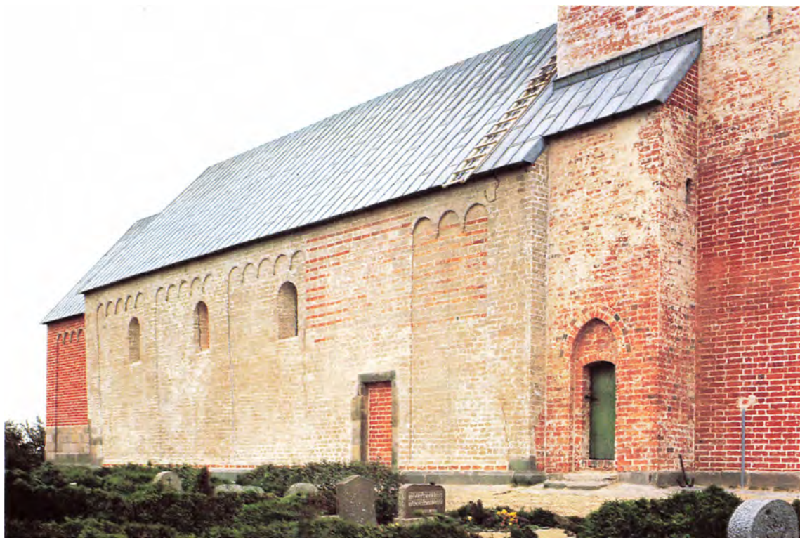
Fig. 10. Kirkens nordside, set fra nordvest, da kirkens facader i sommeren 1966 ved sandblæsning var rensset for puds og kalk. Det ombyggede kor, af teglsten, er fra 1891, hvorimod skibet har bevaret sit middelalderlige murværk af vekselvis tuff og tegl (sml. fig. 9). Til højre i billedet ses det senmiddelalderlige tårn med trappehus, af tegl. Knud J. Krogh fot. 1966. – Nordseite der Kirche von Nordwesten nach Sandstrahlen-Reinigung der Mauern von Putz und Kalk 1966. Der umgebaute Chor aus Backstein stammt aus dem Jahre 1891, wogegen das aus Tuff und Backstein bestehende mittelalterliche Mauerwerk im Langhaus erhalten geblieben ist (vgl. Abb. 9). Rechts im Bild der spätmittelalterliche Turm mit Treppenhaus aus Backstein.
