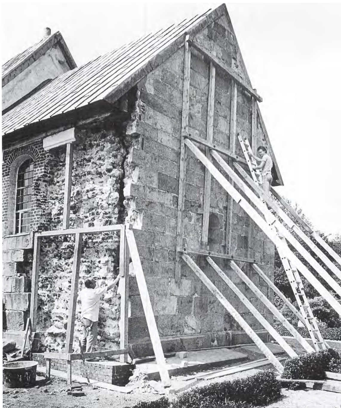
Fig. 7. Korets kvaderstensmurværk under omsætning 1983. Vestkysten fot. i V. Nykirke sognearkiv. – Chor. Quadermauerwerk bei der Restaurierung 1983.
