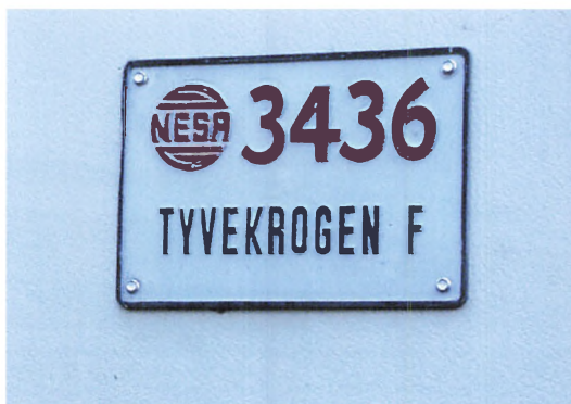
Lystskovens oprindelige navn er som ønsket helt forsvundet fra daglig brug, men kan dog endnu ses på de oprindelige NESAs transformatorstationer rundt omkring på området. (Foto: Forfatteren)
