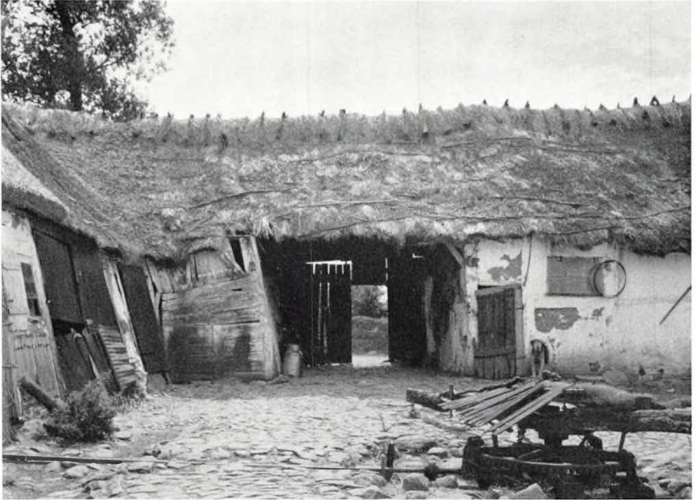
Hans Jensens gård i Pebringe. Set fra stuehuset mod indkørslen. I forgrunden en hestegang. (291)
