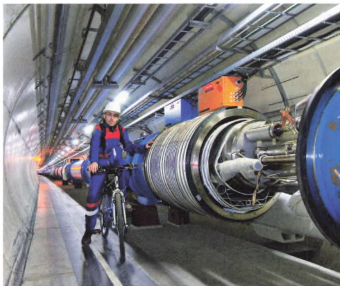
Figur 4. Foto fra LHC-tunnelen med de 15 m lange blå dipolmagneter på rad og række. Samlingen af to magneter er ikke færdig, så man ser nogle af de mange rør- og ledningsforbindelser.
