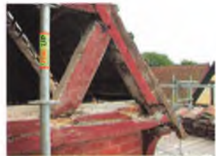
I Den Gamle By er der mange løbende opgaver med vedligeholdelsen. På Trestokværkhuset måtte store dele af tømmeret i gavlen udskiftes.
