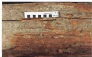
Bagsiden af et svampeangrebet bræt med de mange revnedannelser.
