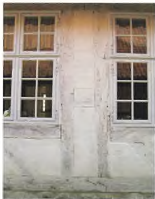
Bindingsværket mod gaden skiller sig ud fra de andre huse med de dobbelte stolper og kalkning "over stok og sten".
