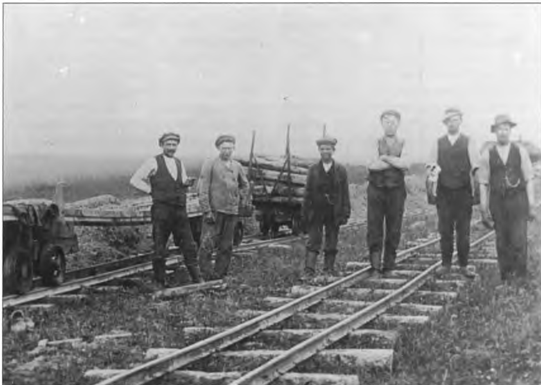
Arbejds mænd fra Damsmarks og Omegns Mergelselskab i færd med at lægge spor ud. (Foto: Alslev Sogenarkiv)
