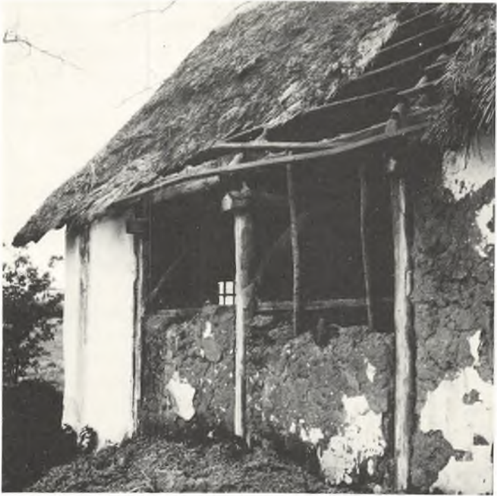
Konstruktionen i gården fra Sonnerup, som nu er faldet helt sammen. Nationalmuseet fot. 1959.
