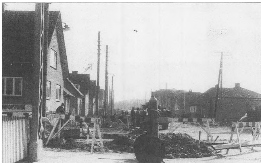
Fjernvarmen gav noget arbejde - for lidt ifølge arbejdsmændene - i de dårlige år i 1950'erne. Her i Nørre allé.
