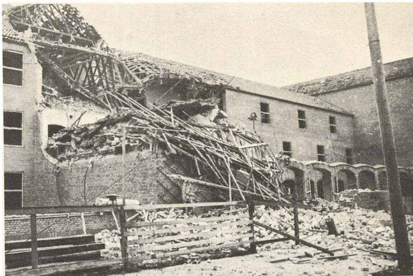
Hovedbygningens Frontparti, der blev ramt af Understellet paa den ene engelske Maskine — men Maskinen klarede sig.
