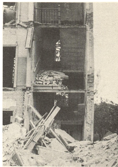
Trappegang i et af de sammenstyrtede Huse i Jernbanegade i Tønder.
