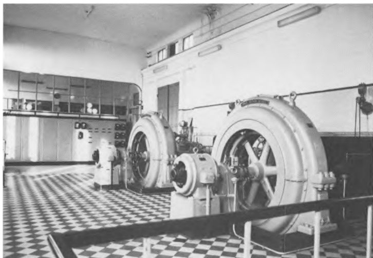
Fig. 1. Fra maskinhallen. I forgrunden de to Titan-generatorer fra 1920, i baggrunden ses manøvrerummet. Foto forf.
