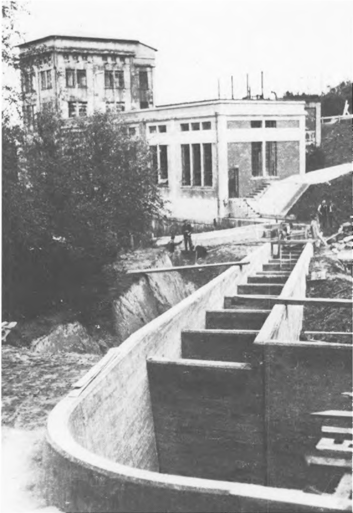
Fig. 14. Den sidste del af byggeriet ved Karlsgårde var anlæggelsen af en fisketrappe. På billedet ses en del af de 42 kamre, hvoraf tre er store hvilebasiner, hvoraf en ses i forgrunden. Foto forf.
