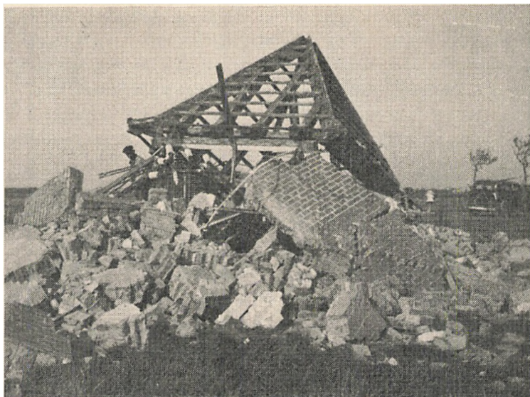
Det illegale arbejde i Sønderjylland kom i gang under forholdsvis vanskelige omstændigheder på grund af de lokale forhold. Billedet her viser transformatoren ved Vilsbæk efter en sabotageaktion den 28. august 1943.
