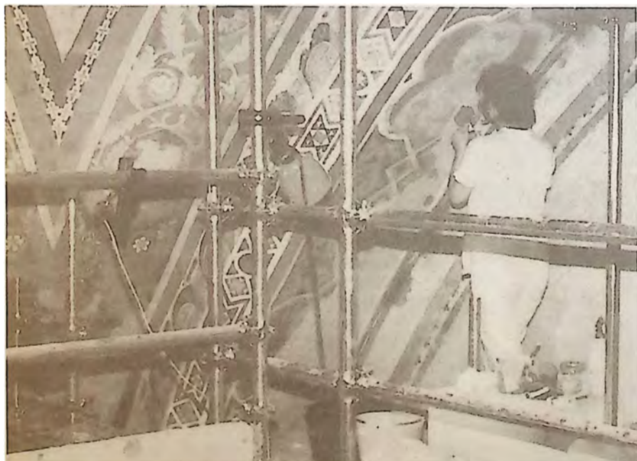
I Assisi har San Francesco-basilikaen fået sin facade igen efter jordskælvet i fjor. Rundt om tårnet, i korskirken og i klostret er man stadig i gang med restaureringen. Stor stykker af hvælvingerne med de uerstattelige fresker styrtede ned, men der arbejdes – som det ses – ihærdigt på at udbedre skaderne. Foto KNA
