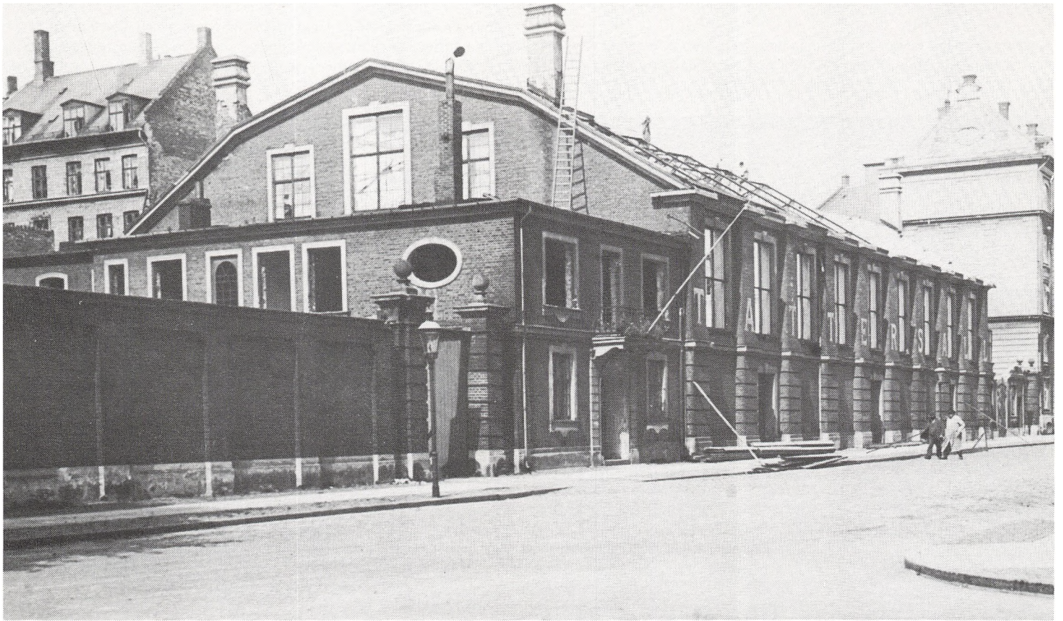
Lørup's Ridehus i Upsalagade under nedrivning i 1931 - set fra Stockholmsgade. Lørup's Ridehus var det eneste private ridehus i København. Mange borgere har i bygningen fået de første og måske sidste lektioner i ridningens svære kunst.
