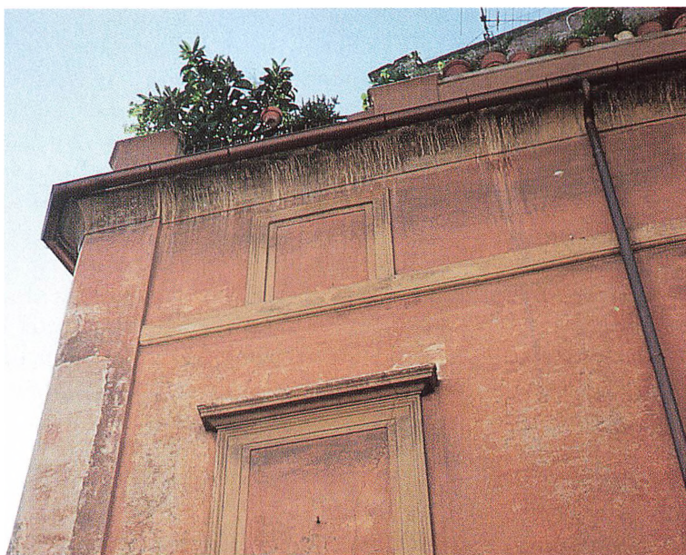
Nedbrudt overflade på romersk facade.
