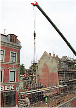
Den 12. juni loftede kranen det første element til huset fra Viborg på plads.
