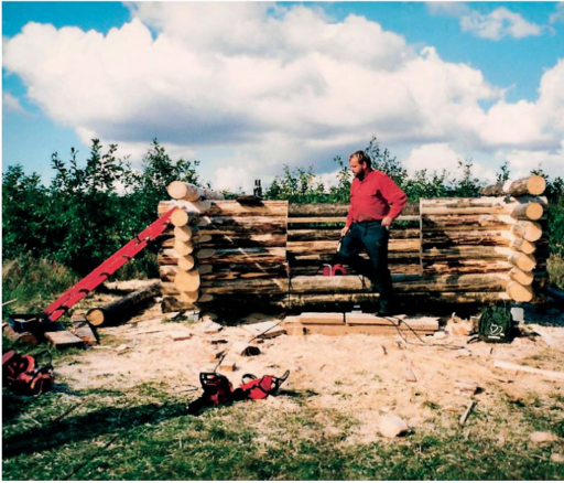
Skovarbejder Bo Jørgensen i gang med bygning af en af Naturskolens shelters.
