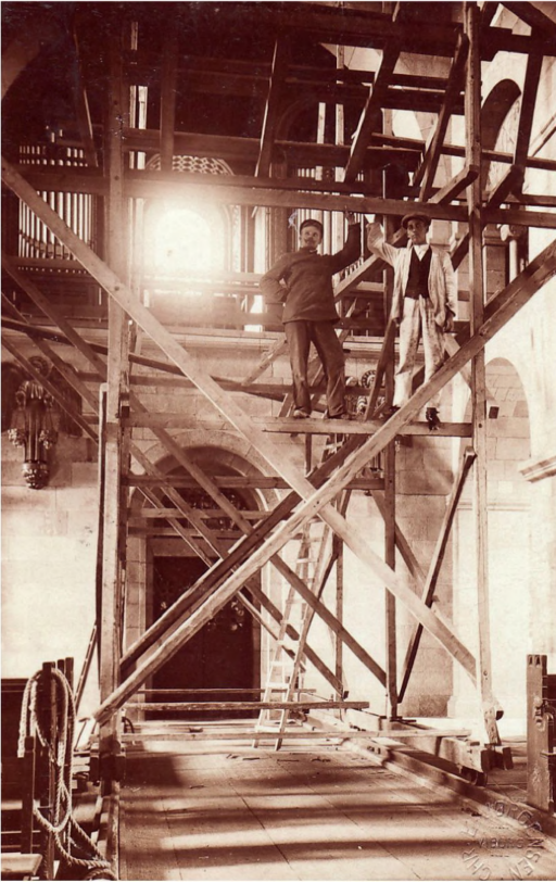
Det flyttelige stillads på skinner under arbejdet i domkirken. Viborg Lokalhistoriske Arkiv.
