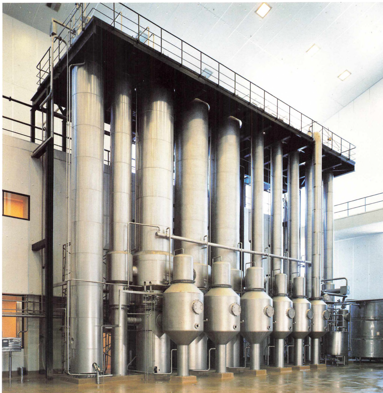
Flertrins faldstromsinddamper med termisk dampkompression leveret til mejeriindustrien i New Zealand.
