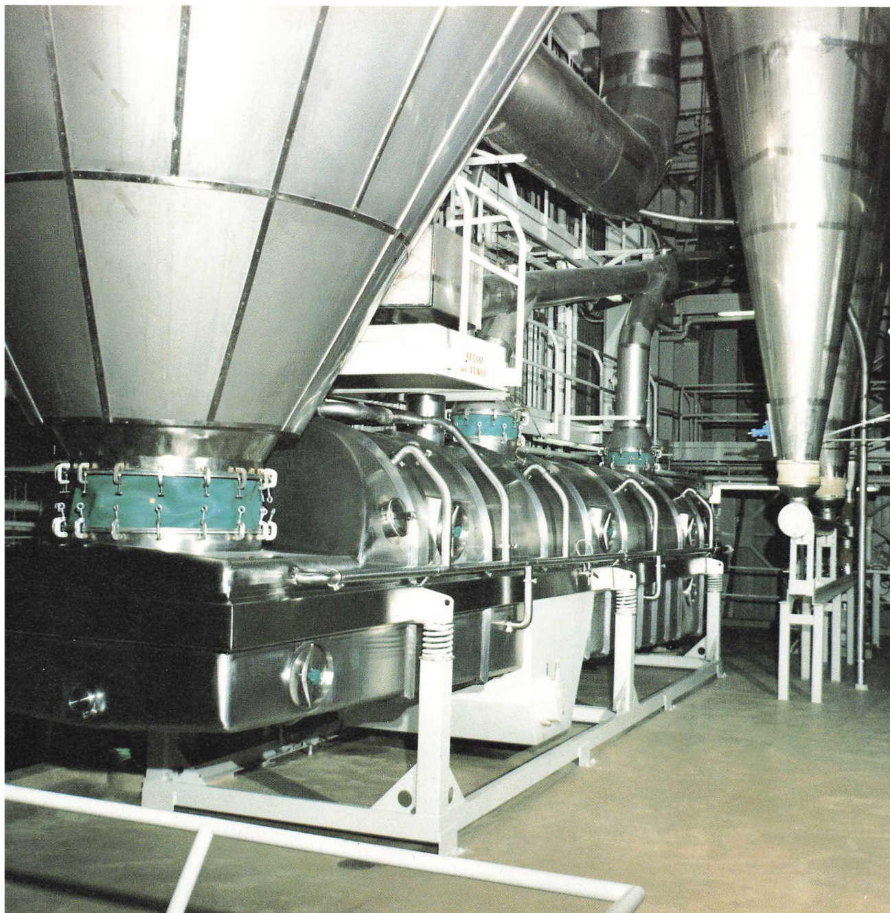
Vibreende fluid bed i sanitær udførelse, tilsluttet et 2-trins spraytørringsanlæg til fremstilling af mejeriprodukter.
