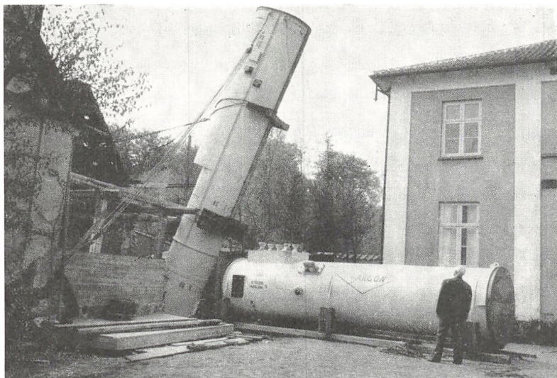
Strandmøllen er den første og fra omkring 1960 hidtil eneste danske fabrik, der producerer argon til brug i svejseindustrien. Det store argon-anlæg blev installeret under Christian Niensens overopsyn (yderst til højre).
