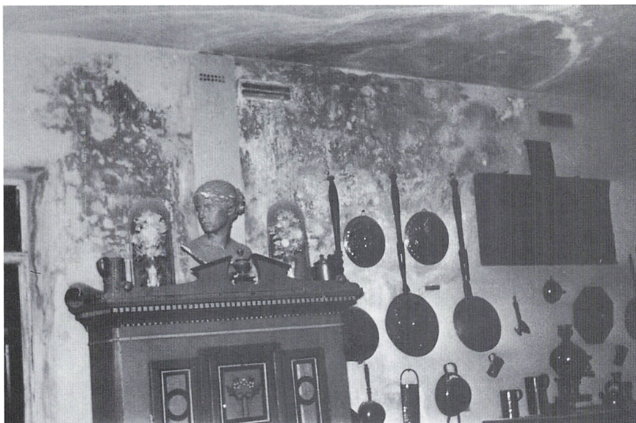
Få år efter opførelsen var huset i et hastigt fremadskridende forfald. Fugt og mugpletter bredte sig over loft og vægge.
