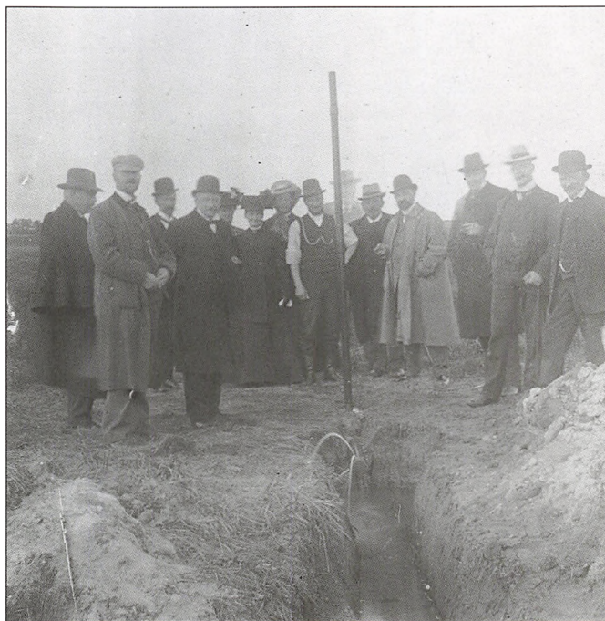
Byrådet fotograferet ved én af borererne i Jegstrup. Fotoet er udateret, men det er sandsynligvis taget den 8. september 1910, hvor det vides, at politikerne besøgte Jegstrup. Midt i billedet ses vandværksudvalgets formand, Hjalmar Kjems, med opsmøgede ærmer. Skive byhistoriske Arkiv.
