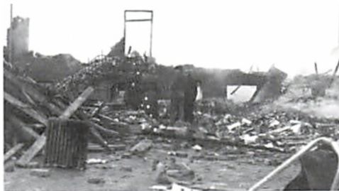
B&O's hovedbygning efter sprængningen. Rammen fra hoveddøren står stadig, og foran er opryddningsarbejdet allerede i gang. (Foto: Struer Lokalthistorisk Arkiv).
