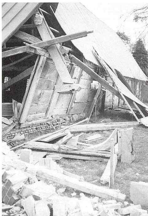
På billedet ses tydeligt konstruktionsdelene i et bulhus, og hvad der sker, når bindbjælkerne saves over! Foto: Jørgen Toft Jessen.
