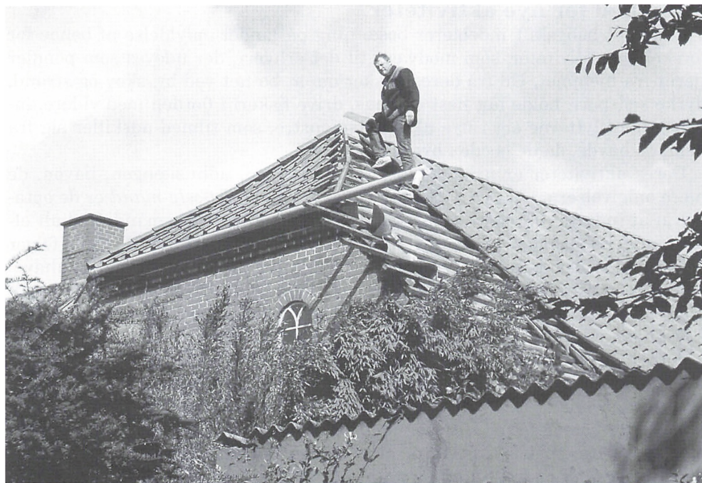
Fig. 4.6. Carsten Lundhøj i færd med omlægning af taget på udhuslængen, som nu er under reparation og ombygning, efter at man i de første år siden overtagelsen har arbejdet med indretningen af stuehuset. Foto: Gunnar Solvang, 1998.
