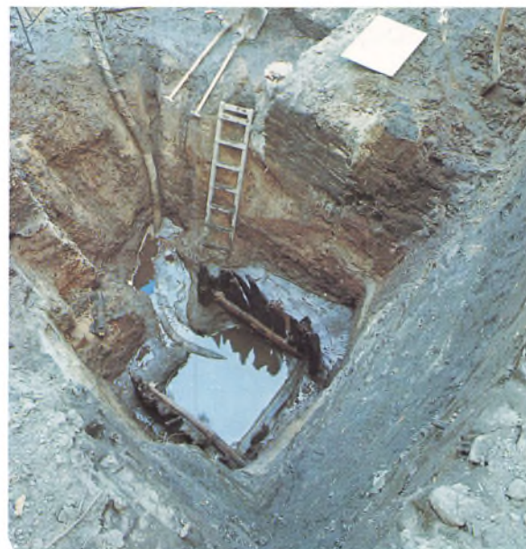
Brønd under udgravning. Fra nuværende terrænhøjde ned til grundvand og bevaret tømmer er der ca. 8 meter.
