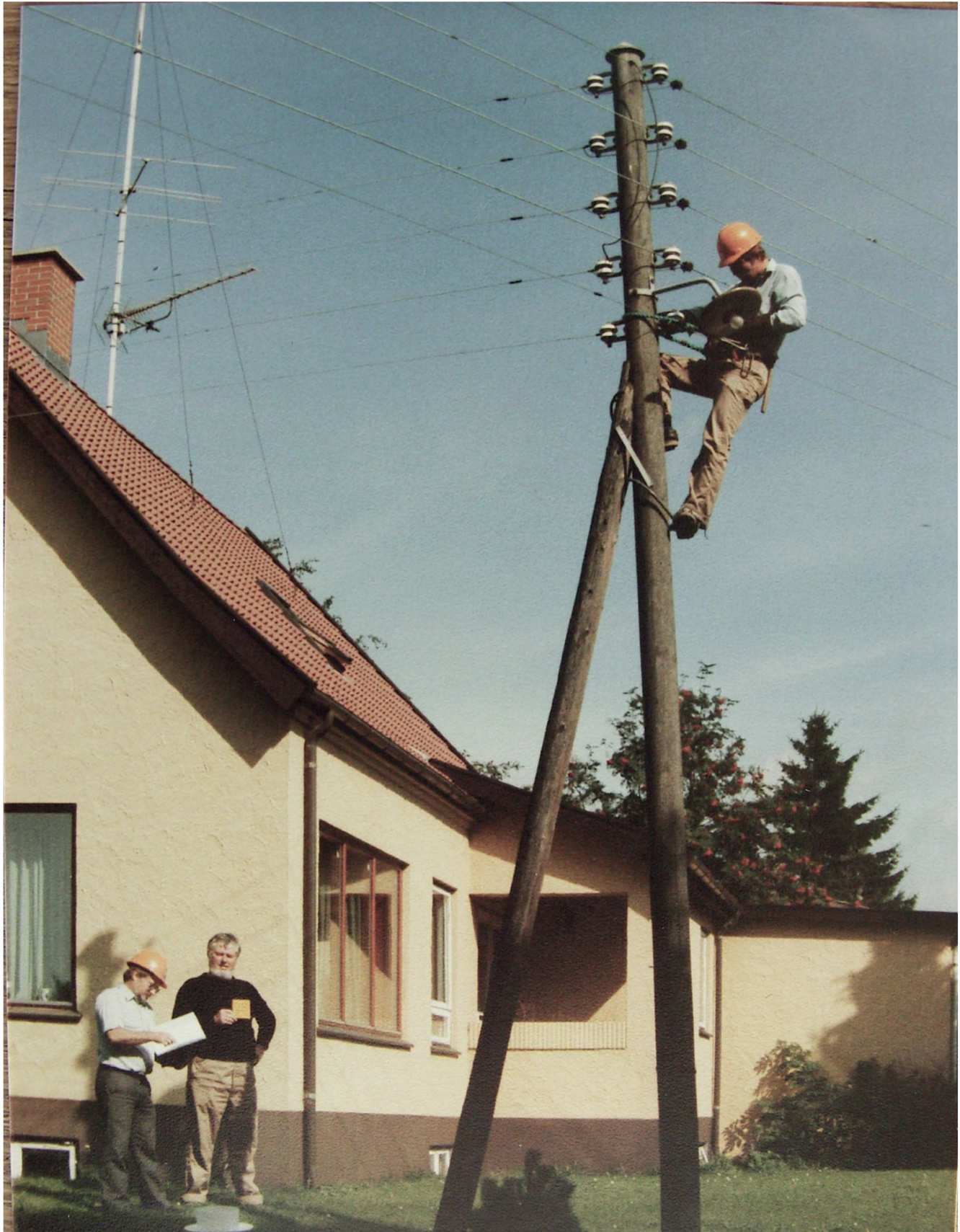
Luftledningsarbejde i Vejby år 1985. Nr. 1 fra venstre er Gorm Christensen fra NESAs, nr. 2 er overmontør Kaj Bager. Foto: Privat udlån.
