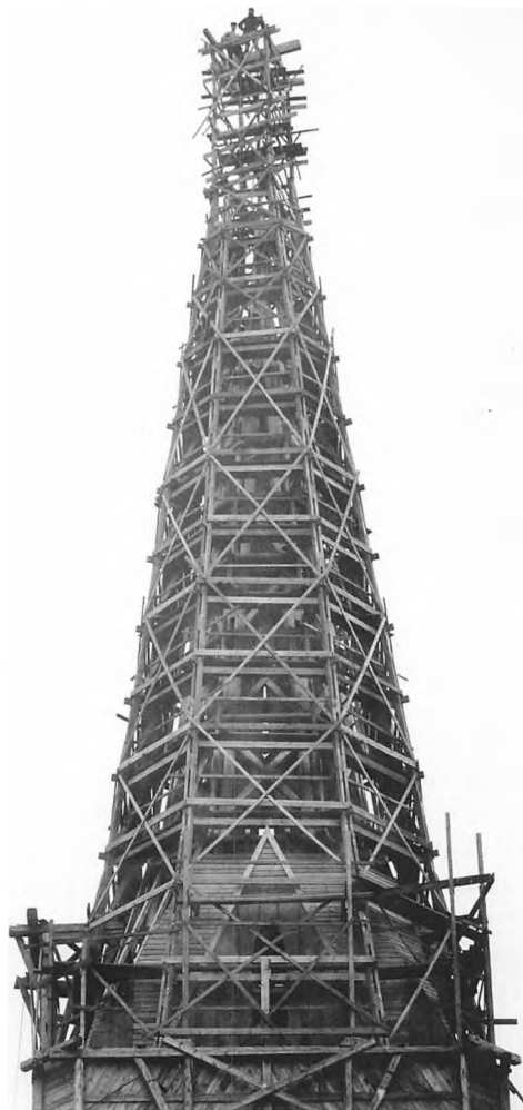
Skt. Olai Kirke stod uden spir fra 1737 til man i 1898 fik bygget det nye spir. Tårn og spir har en højde på 69 meter. Billedet er fra 1898 og fra Skt. Olai Kirkes arkiv.
