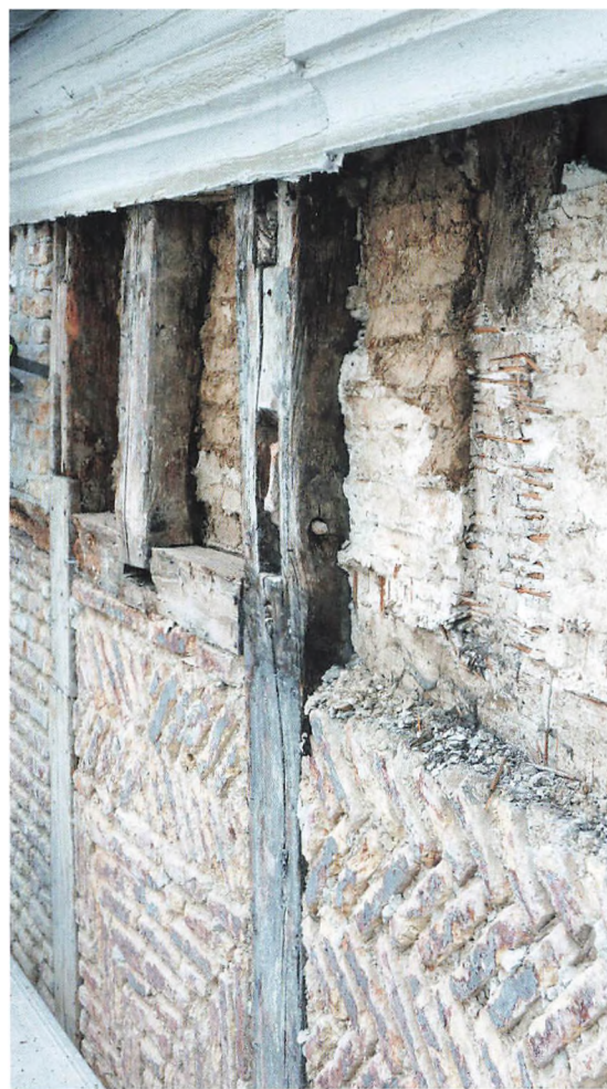
Bindingsværk og tavl efter afrensning. Løsholte og dokker under rekonstruktion. Lervæggen med strå ses bagved. Foto: Finn Strabo.
