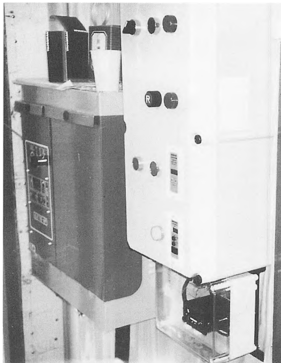
Maskinrum. Panel for varme- og fugtstyring.
