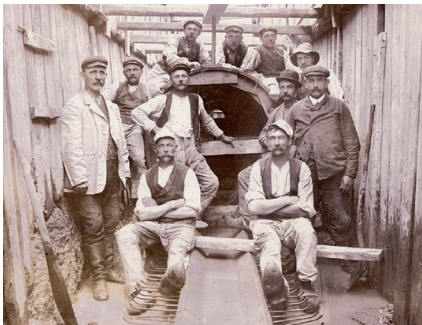
Arbejdere præsenteret ved et større kloakarbejde på Dalgas Boulevard i 1909. Sådan har situationen også set ud for pionererne i København i 1860'erne, hvorfra der ikke er billedgengivelser. Fotografi: Frederiksberg Forsyning.
