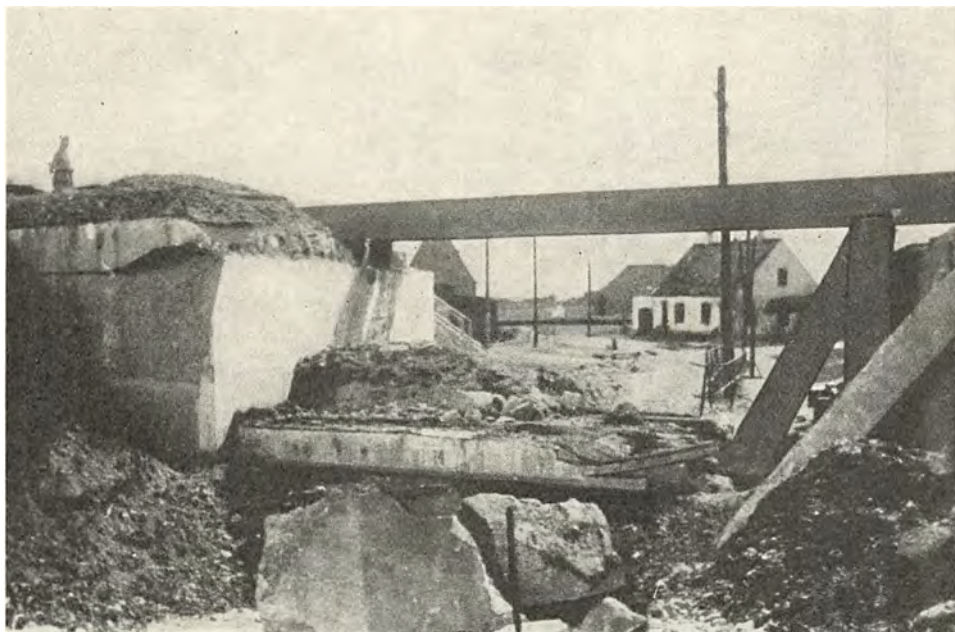
Her ser man Jernbanebroen ved Jerne nær Esbjerg . Af den gamle Bro er der intet tilbage. En interimistisk Bro af Staalbjælker er blevet bygget, men den giver ingen sikker Drift — og kan let lokke til nye Attentater!
