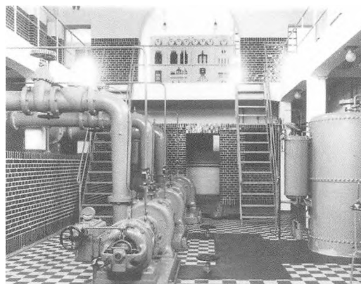
Brøndpumperne i Brøndkælderen.
