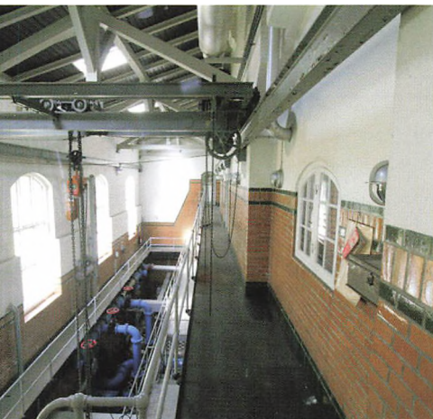
Brøndkælderen i dag. I 1970 blev pumperne ændret til at køre på elektrisk drift.
