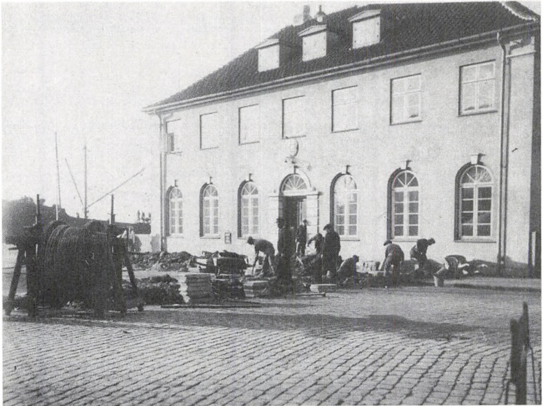
Nedlægning af jordkabel til Stege postbygning 1927 i anledning af sammenslutningen. (Foto: Dansk Post- og Telegrafmuseum).
