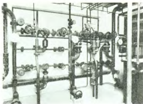
Varmecentral i Hotel Astoria.
