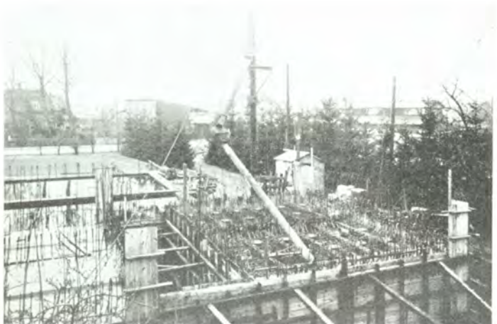
Hurtigfilter, Hillerød Vandværk, opført 1934.
