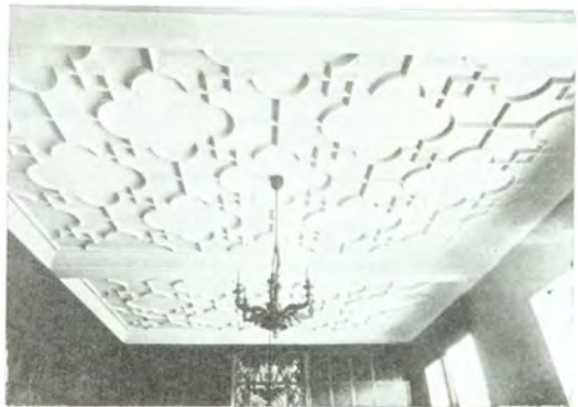
Stukloft i Axelborg.
