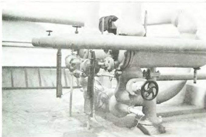
Varmecentralen i Odense Alderdomshjem. udført af Smedemester Juul, Odense.
