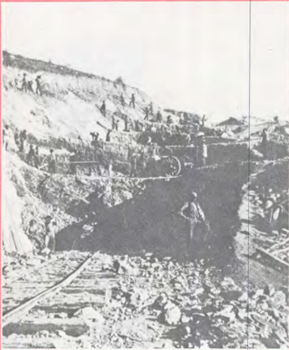
Møjsommeligt arbejder Union Pacific's arbejdere sig gennem et bakkedrag. Behovet for menneskelig arbejdskraft var stort: Central Pacific i vest anvendte kinesiske og japanske immigranter, Union Pacific i øst irske, samt borgerkrigsveteraner, der meldte sig på arbejdsmarkedet efter 1865.
