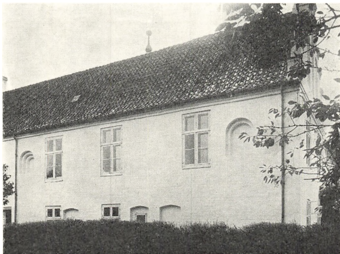
Fig. 4. Nordfløjens vestende, set fra nord. I dette bygningsafsnit findes ialt 7 vindueslysninger fra Ejler Bryskes borg (ca. 1520), bevaret som blændinger.
