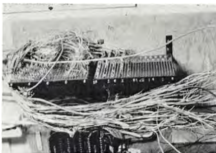
Vagtcentralens omstillingsbord under opbygningen. Ledningerne er tilsyneladende placeret efter VF-systemet.
