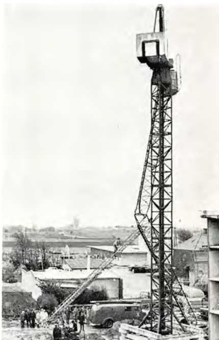
Vordingborg Brandvæsen stillede med en efterløberstige, men byggekranen var meget høj, hvilket fremgår af billederne. Bemærk kontravægtens placering og den knækkede kranarm.
