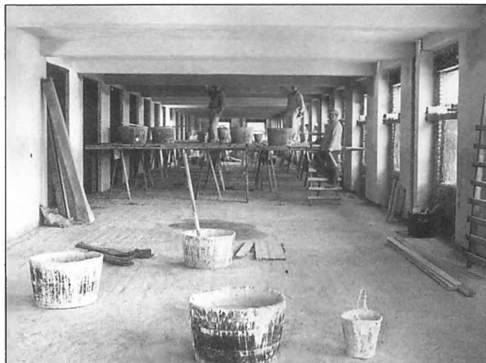
Håndværkere udfører pudsearbejde på fjerde sal i vestfløjen i sensommeren 1953 (Frederiksberg Stadsarkiv).
