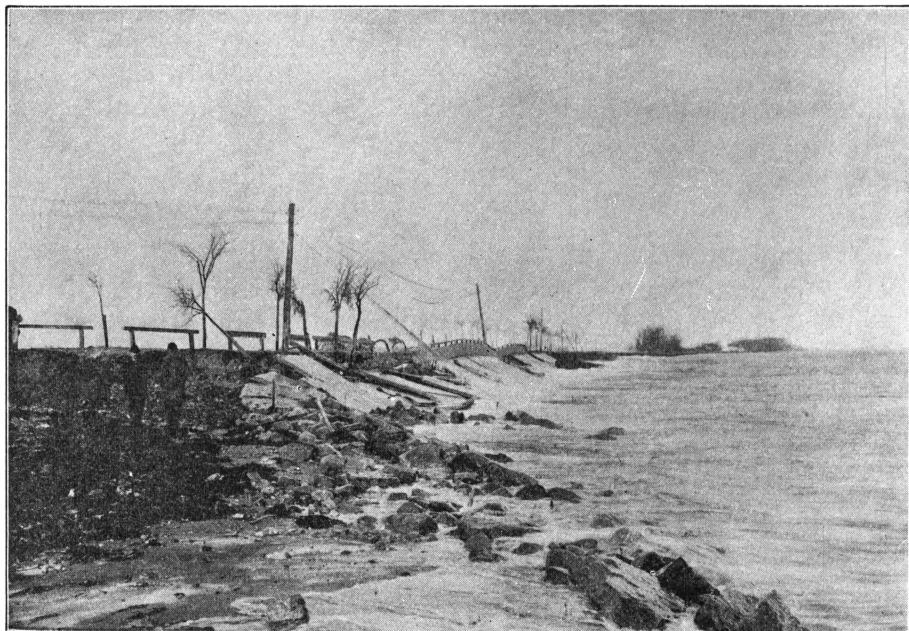
Efter Højvandet 1913, da Næsgaards Dæmning ved Skovboledet blev fuldstændig jævnet og Landevejsdæmningen stærkt medtaget.
