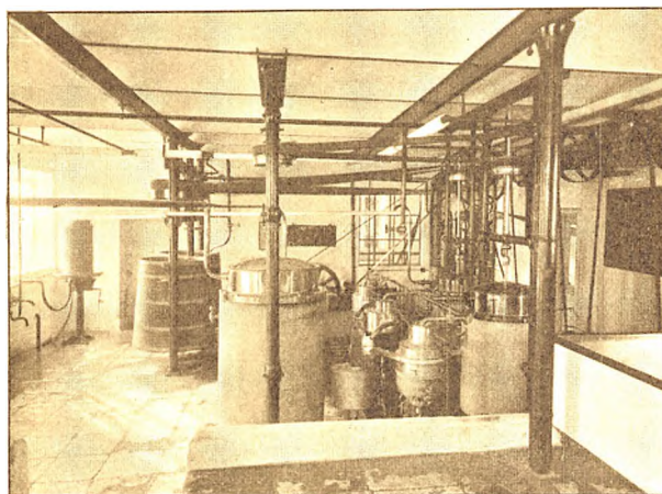
Centrifugerummet i et stort Andelsmælkeri.
