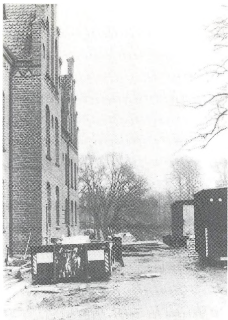
I facaden mod Grønne Plads kommer en ny adgangsvvej til køkkenet. Her sætter byggeriet synlige spor med skurvoagne og containere.
