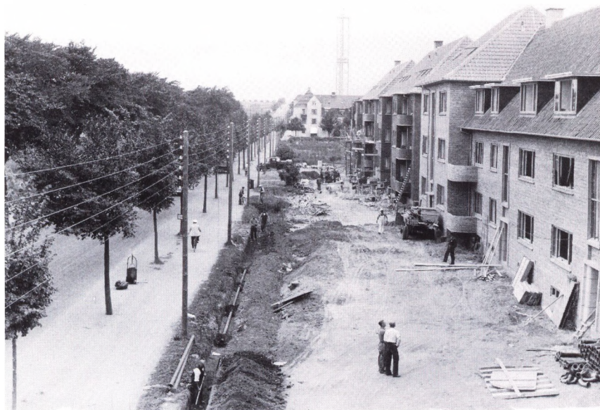
Nybyggeri på Bolbro Bakke i slutningen af 30'erne. I baggrunden knejser Odinstårnet på bakkens top (E. Christoffersen fot., Møntergården).
