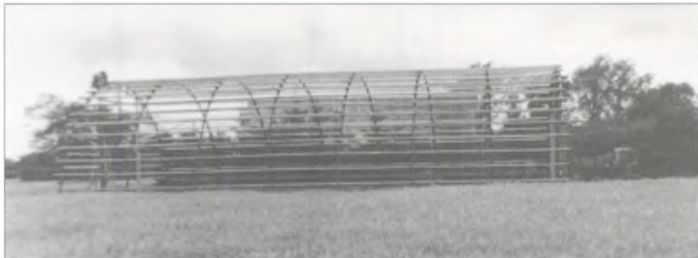
Opførelse af rundbuehal, 1974. Der blev stillet store krav til landmandens alsidige evner, når der skulle opføres nye bygninger. Ofte forestod han selv byggeriet med hjælp fra familien (Sjælland).
