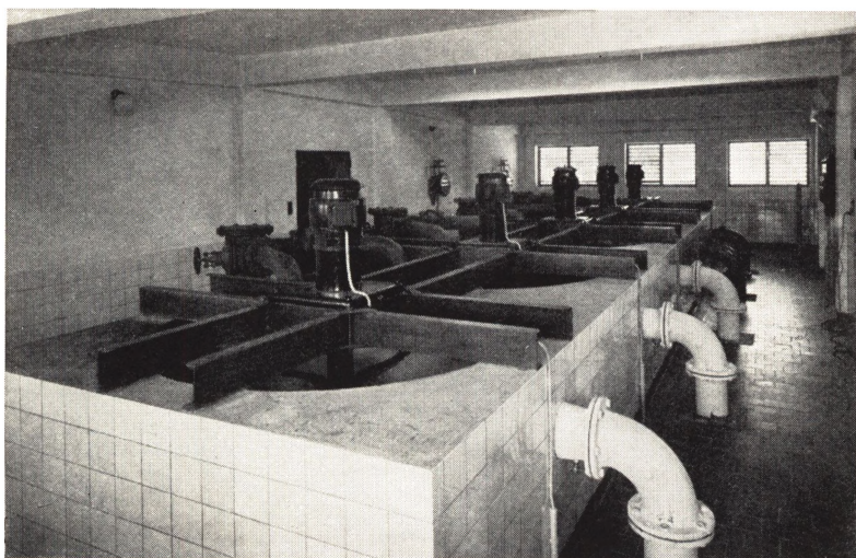
Den nye iltningshal med de 5 pista beluftere.
