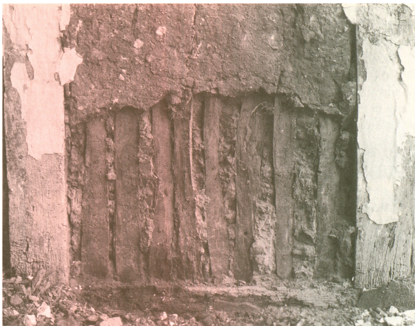
Fig. 7. Udsnit af lervæg under nedbrydningen i 1934. Bemærk de tæstillede støjler, hvorpå lerklining er klasket. Foto Arne Ludvigsen.
